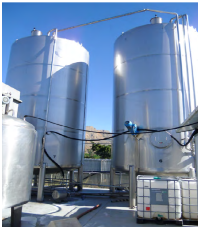
Depósito de recogida de aguas residuales de la línea de zumos, concentrados de frutas y restos antes del tratamiento primario.
